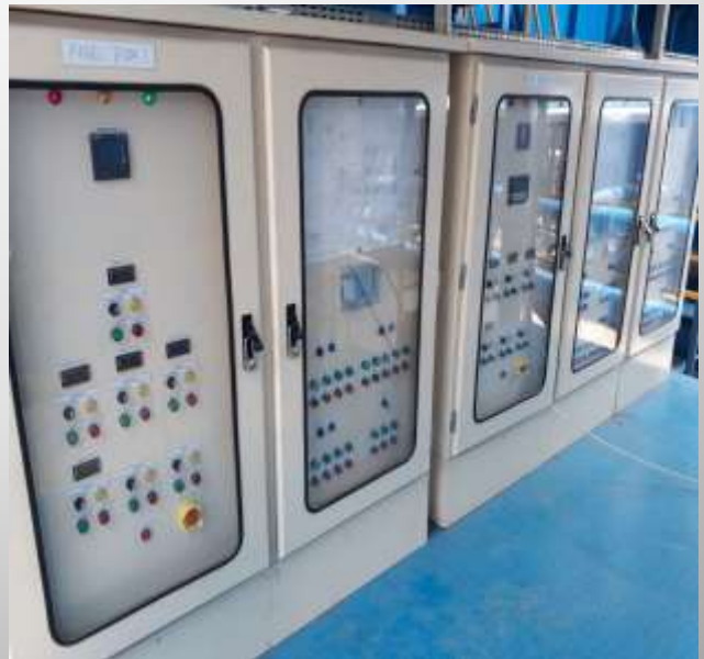
Panel WTP Customer : PT. Padi Hijau Buana Lokasi : Gresik
